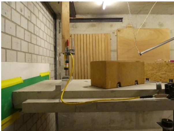
Abbildung 12: Übersicht der Einbausituation und Hammerwerkspositionen auf dem Podest
