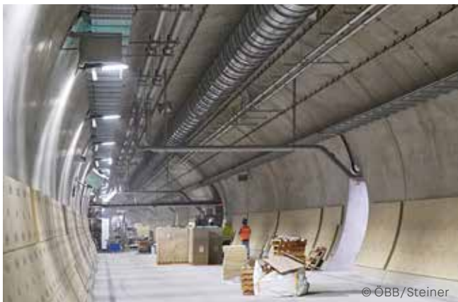
Tunel techniczny, Koralmtunnel (Karyntia/Styria, Austria)
