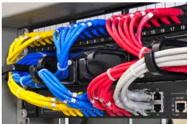
Uporządkowane okablowanie znacząco podnosi efektywność systemu: ułatwia diagnostykę oraz prace konserwacyjne, a także zapewnia lepszą cyrkulację powietrza i odprowadzanie ciepła.
