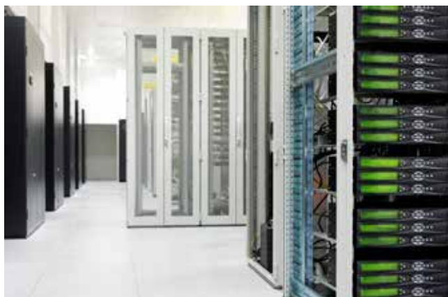
Centra danych są dzielone na strefy ze względów bezpieczeństwa i organizacyjnych. Redundantna konstrukcja infrastruktury zwiększa niezawodność.
