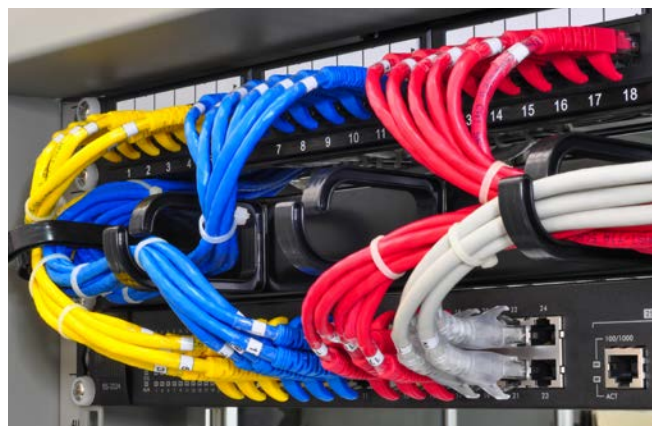
Eine geordnete Verkabelung steigert die Effizienz der Anlage: Diagnose- und Wartungseingriffe werden erleichtert, die Wärmeabfuhr verbessert.
