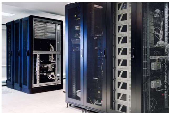
Serverové skříně a stojany slouží ke stabilnímu uložení hardwaru a zajišťují jeho řádný provoz.
