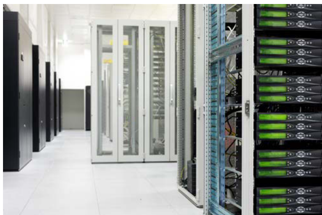
Datová centra jsou z bezpečnostních a organizačních důvodů rozdělena do zón. Odolnost proti výpadkům zvyšuje redundantní návrh síťové infrastruktury.
